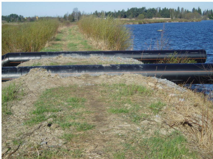
Kuva 6.18 Pumppaamon poistoputket Roismalan tulvapenkereellä. (Kari Virtanen)
