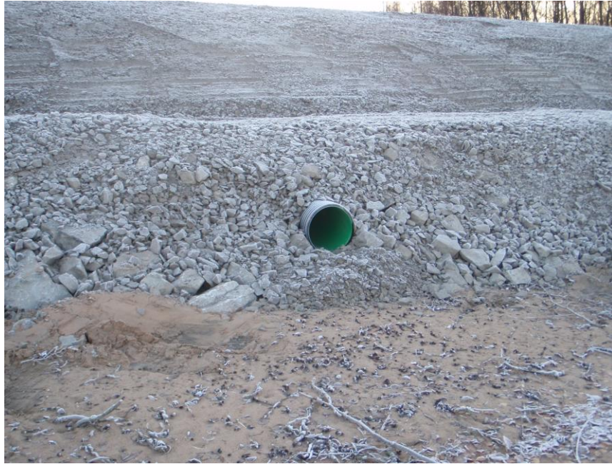
Kuva 6.10 Tulvapenkereen läpi kulkeva putki.
