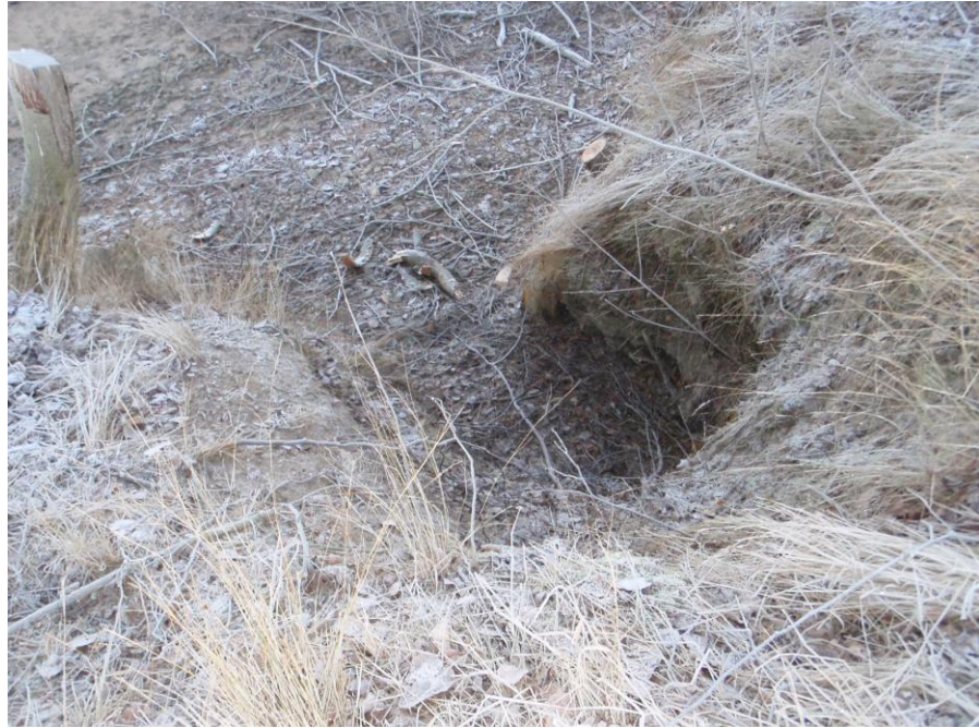
Kuva 7.2 Ulkoisen eroosion aiheuttama syöpyä Porin tulvapenkereen märällä luis-kalla.
